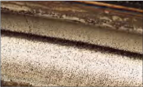
照片 9-1 部位： 回转支撑轴承的外圈 损伤特征： 滚道面呈现梨皮状，凹坑底部已被腐蚀
