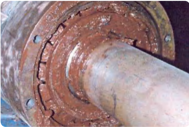
泵单元的圆锥滚子轴承 密封失效，轴承腐蚀、润滑脂变红。
